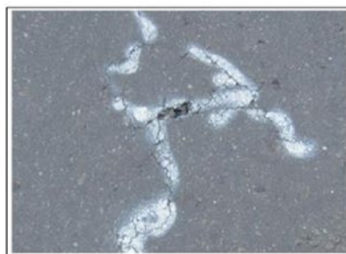
FOTO 2. DETALLE DE LA FALLA A SELLAR.
