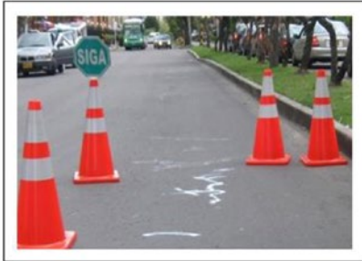
Foto 1. Ubicación general de la falla sellada.
