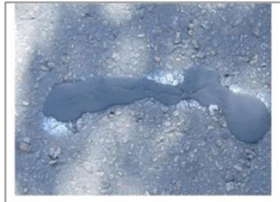
Foto 4. Detalle 2 de la falla sellada.
