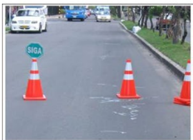
FOTO 1. UBICACIÓN GENERAL DE LA FALLA.
