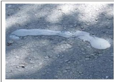
Foto 3. Detalle 1 de la falla sellada.
