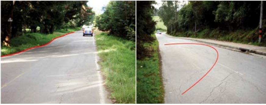
Figura 1. Deformaciones presentes en la vía Tenjo-Siberia asociadas al comportamiento volumétrico de la subrasante arcillosa
