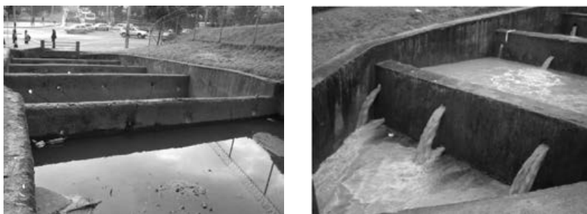
Figura 1. Estructura hidráulica en canal de la calle 127, Bogotá
