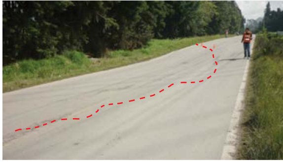
Figura 1. Deterioros en superficie asociados a la acción de barreras vivas, vía Siberia-Tenjo
