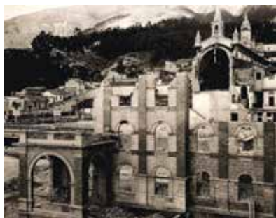
Figura 5. Estado en el que quedó el edificio del Instituto de La Salle después del incendio, 1948
